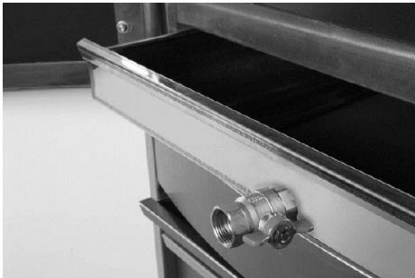
Válvula de drenado abierta (manija horizontal)
